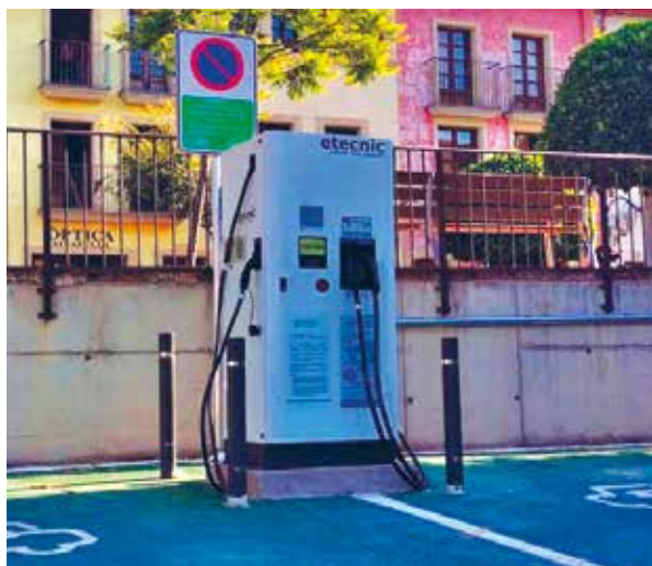
El punt de recàrrega de vehicles elèctrics està ubicat a l'aparcament municipal del carrer Alcalde Pijuan, / AJ. ALTAFULLA
