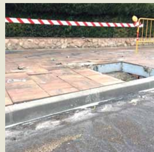
Imatge dels efectes de les fortes pluges en aquesta zona del passeig Miramar. / CEDIDA
