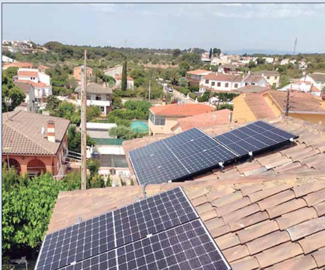
Una imatge d'una instal·lació solar a Creixell.
